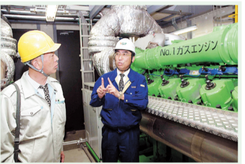
発生されたガスは、タールを取り除いた後、ガスエンジン発電機に移され、発電が行われます。
